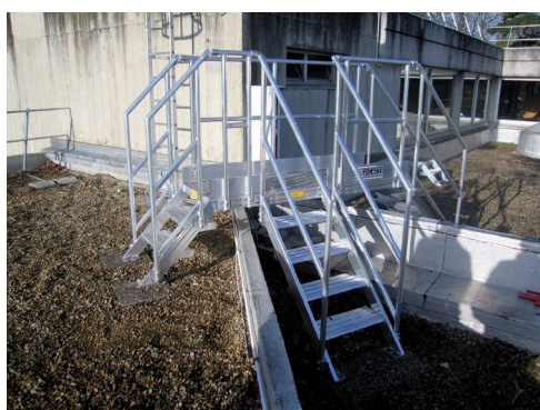
Escalier pour passage de tuyauterie sur toiture-terrace
